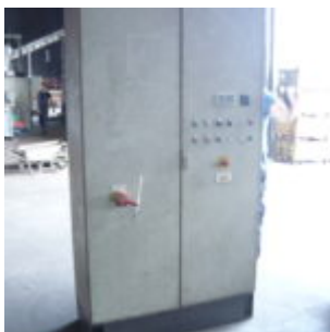
Szafa sterująca gotowa do transportu
